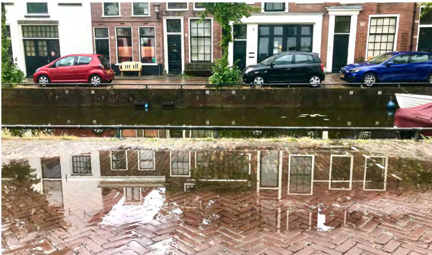
De locatie waar de containers moeten komen. Direct naast rijbaan en water. De verzakking is goed te zien.
